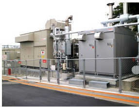
コージェネレーションシステム
